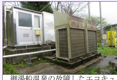
御湯船温泉の故障したエコキュート施設
