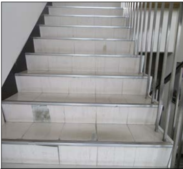
タイルが劣化で剥がれた集落センター2階への階段
