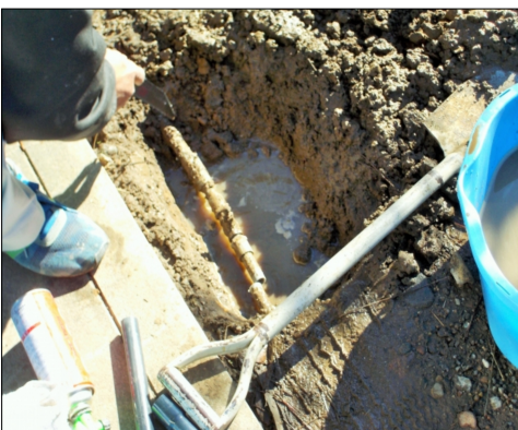
毎年10回程度、水道管の損傷により緊急工事が行われている。
