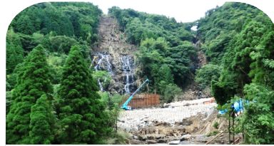
平成24年九州北部豪雨 写真は国道57号滝室坂
