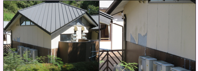
劣化が著しい御湯船温泉外壁
