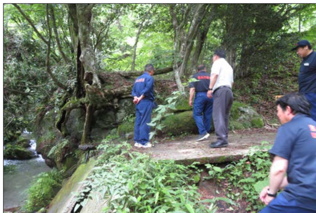
山吹水源駐車場付近にある水波み場が河川の洗堀により危険な状態であることを確認
