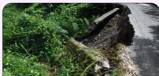
村道牧野・御湯舟線令和6年災害箇所
