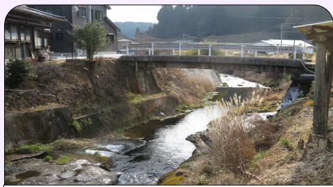
改修が必要な山鹿川に架かる鶴崎橋
