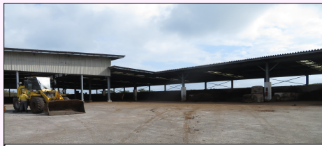
屋根の老朽化により雨漏りする産山村堆肥製造施設
