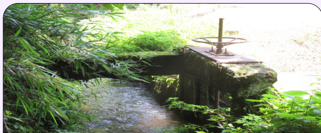
写真は、老朽化により改修が必要な中新井手水路排水吐
