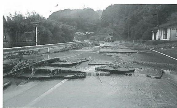
玉来川の越流により、国道40号の舗装が崩壊し、全面通行止め。
