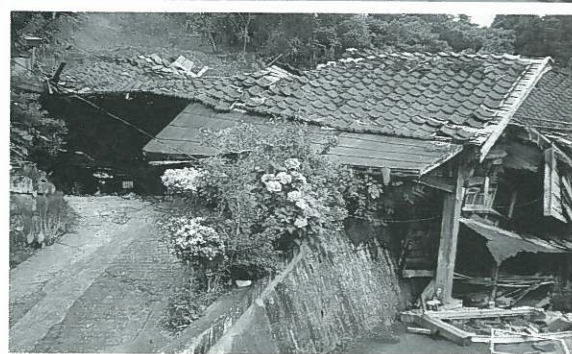
裏山の土砂崩れで納屋が崩壊。車両や農耕車などが被害を受けた。
