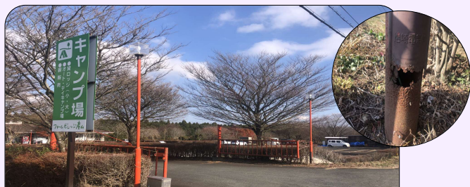
ファームビレッジ産山の街灯支柱の腐食
